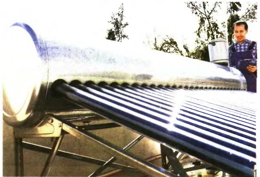
Τα νοικοκυριά που εντάσσονται στο πρόγραμμα θα δουν μείωση κατανάλωσης για ζεστό νερό κατά 65%.
